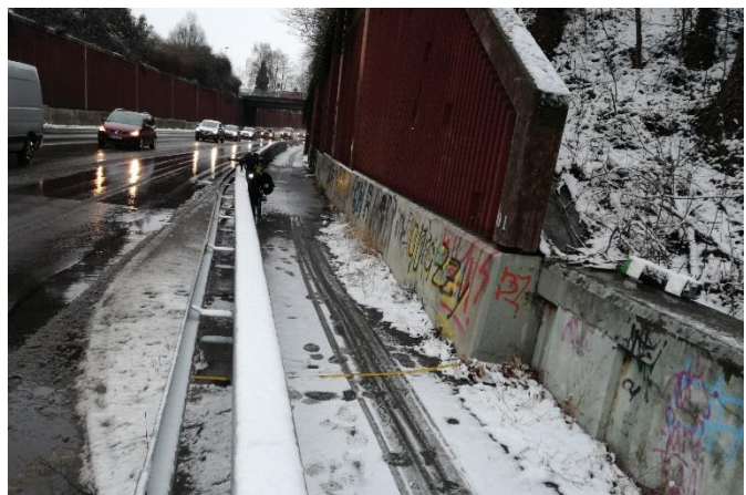
Am Brückende Richtung Mondorf beträgt die Wegbreite nur 1,40 Meter – der ADFC fordert, eine schmalere Leitplanke fahrbahnnahe aufzustellen
