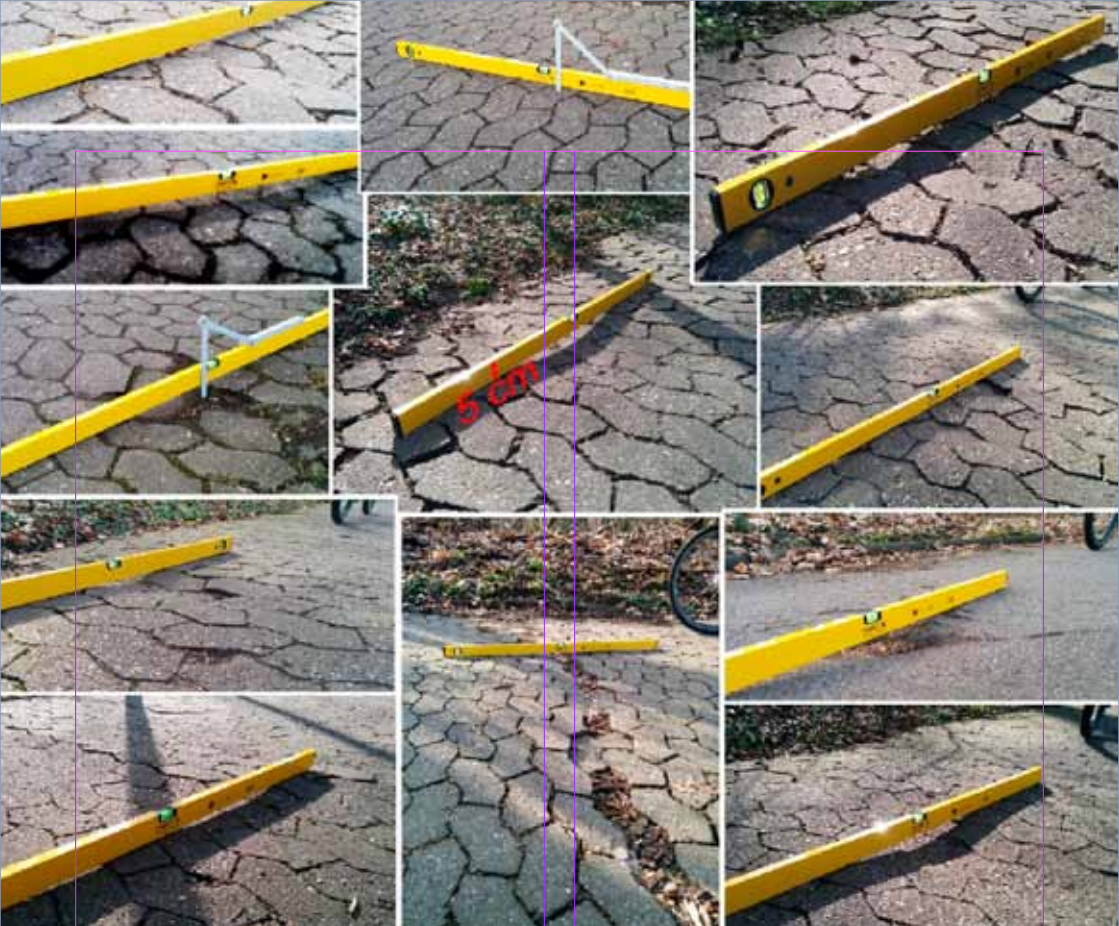
Schlaglöcher auf dem Dhünnradweg: Mit Wasserwaage und Zollstock.
