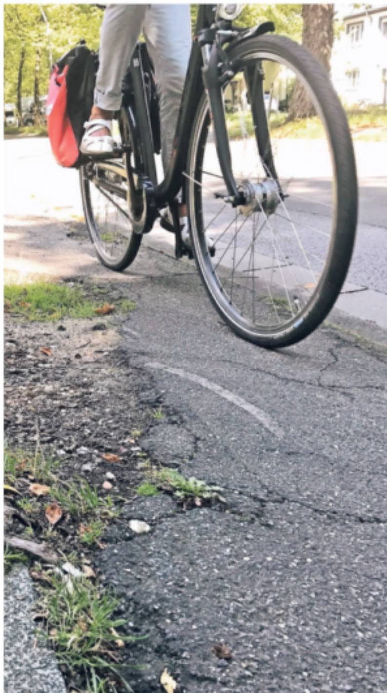
Der Radweg an der Hohenzollernstraße gehört zu den schlechtesten in der Stadt. Dort warnen jetzt Schilder vor den Schäden.
