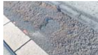
Beim Entfernen des Schutzstreifens wurde die Fahrbahndecke beschädigt.
